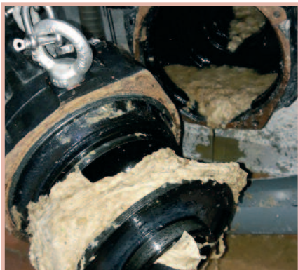
Dieses Foto entstand am Pumpwerk in der Lempdeser Straße.
